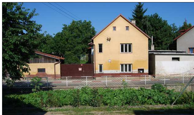
I měsíc po povodni bylo vidět, kam až sahala voda
